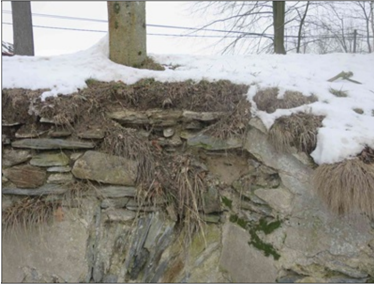
degradace zdiva čelní zdi
