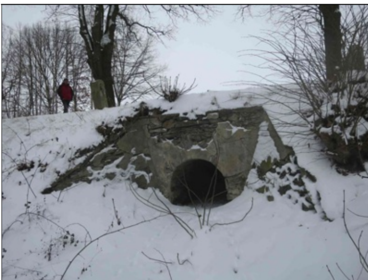
pohled na čelní zeď s opadanou ochrannou omítkou
