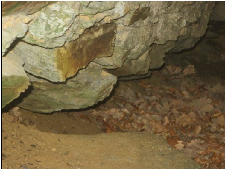
DTTO - hloubkové podemletí dřívku opěry
