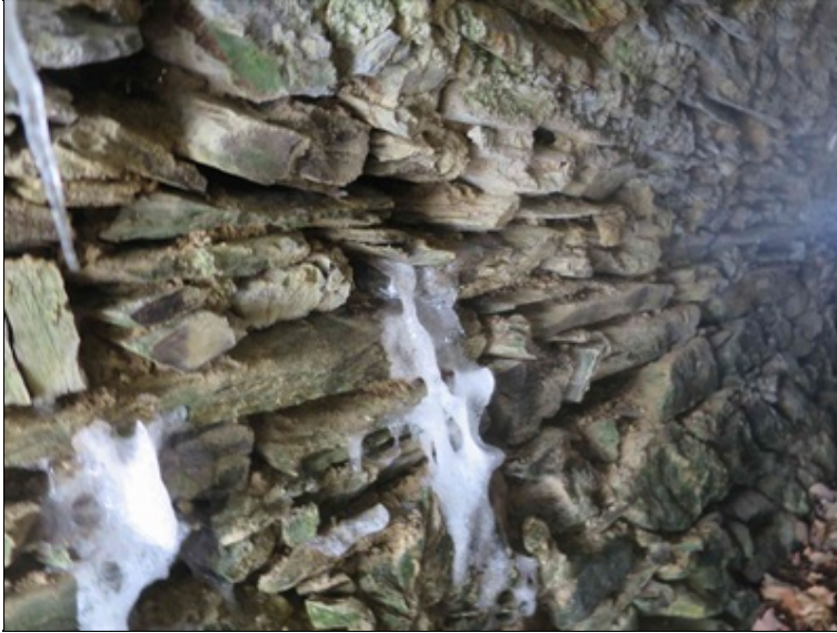
zdivem klenbového pasu protéká značené množství vody, která vyplavuje spárovou maltu
