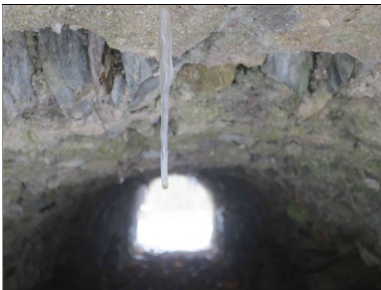
zdivem klenbového pasu prosakuje značné množství vody
