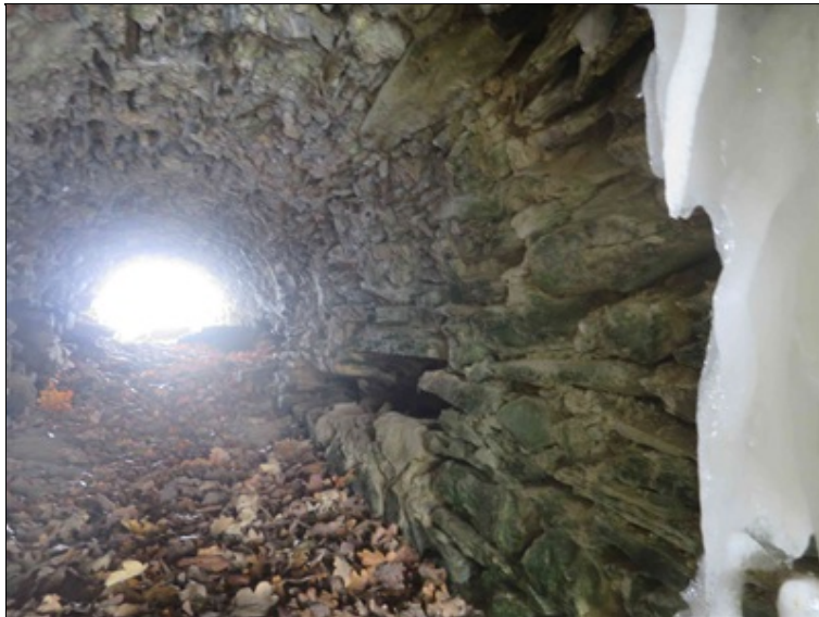
hloubková kaverna ve zdivu opěry
