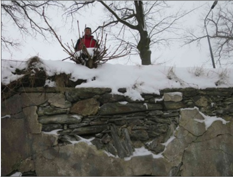
v oblastech odpadlé omítky je obnažené zdivo čelní zdi s hloubkově vyplavenou spárovou maltou
