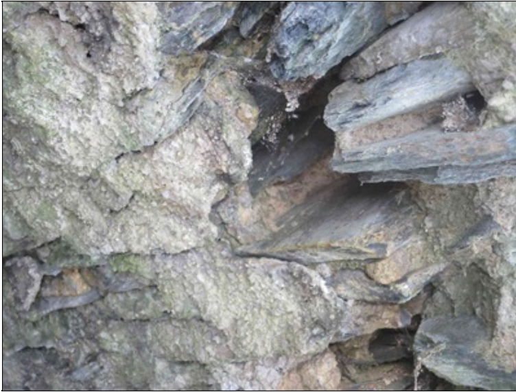
příčná trhlina v klenbovém pasu s vyplavenou spárovou maltou
