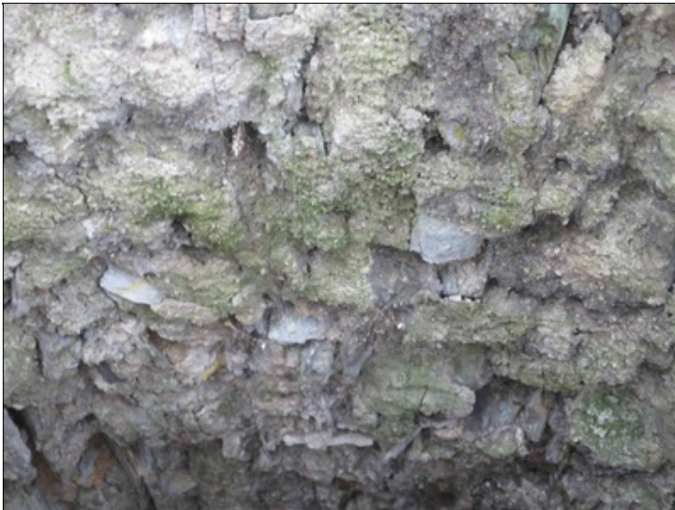
podhled zdiva klenbového pasu v "uspokojivé" oblasti
