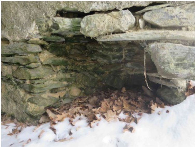
hloubková kaverna ve zdivu dřívku opěry
