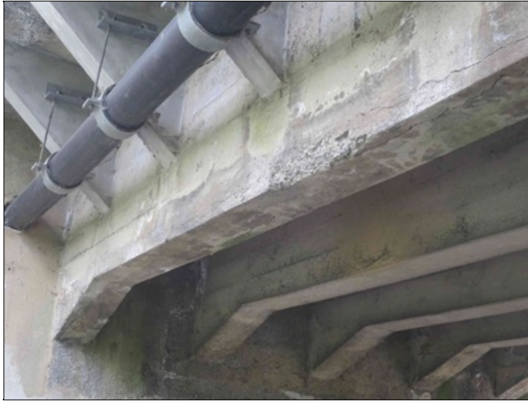
DTTO - hloubková degradace betonu v oblastech průsaků
