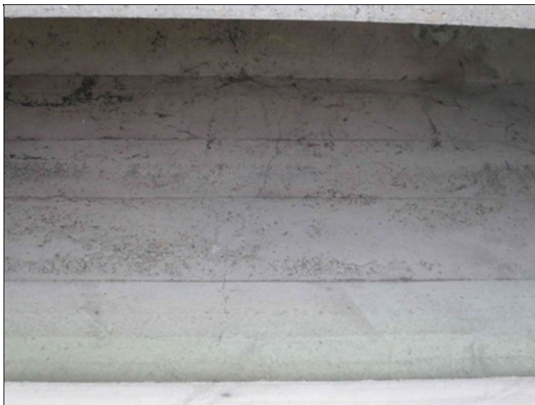
příčná trhlina na líci 4. trámu
