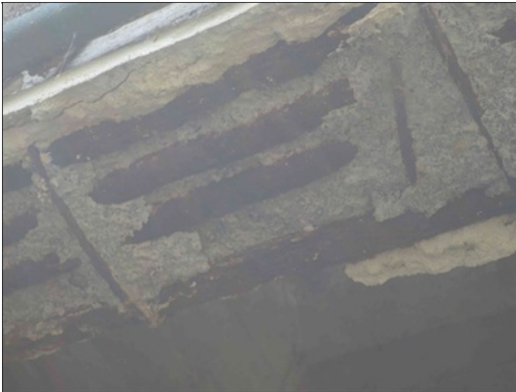
DTTO - intenzivní koroze výztuže, hloubková degradace betonu trámu
