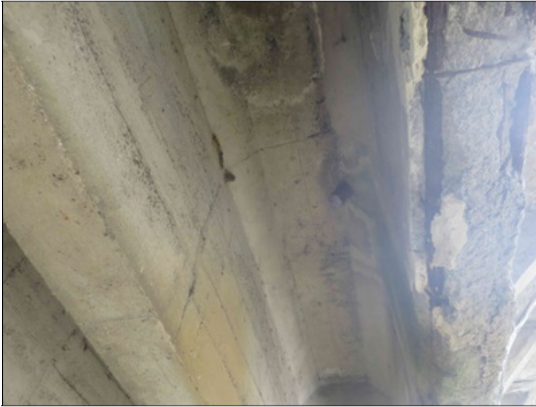
stopy po průsaku v okolí trubky odvodňovače na vnitřním boku 1. trámu
