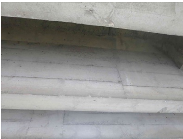
příčná trhlina s výluhem pojiva na boku trámu
