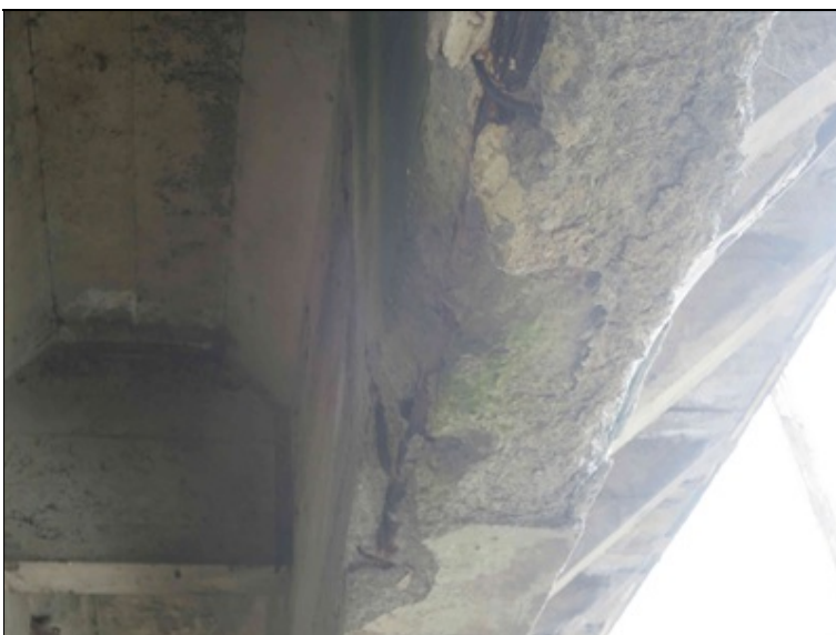
důsledky průsaku deskou mostovky na spodním líci 1. trámu
