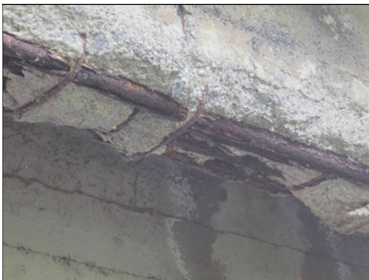
DTTO - detail výrazného oslabení průřezové plochy nosné výztuže korozí
