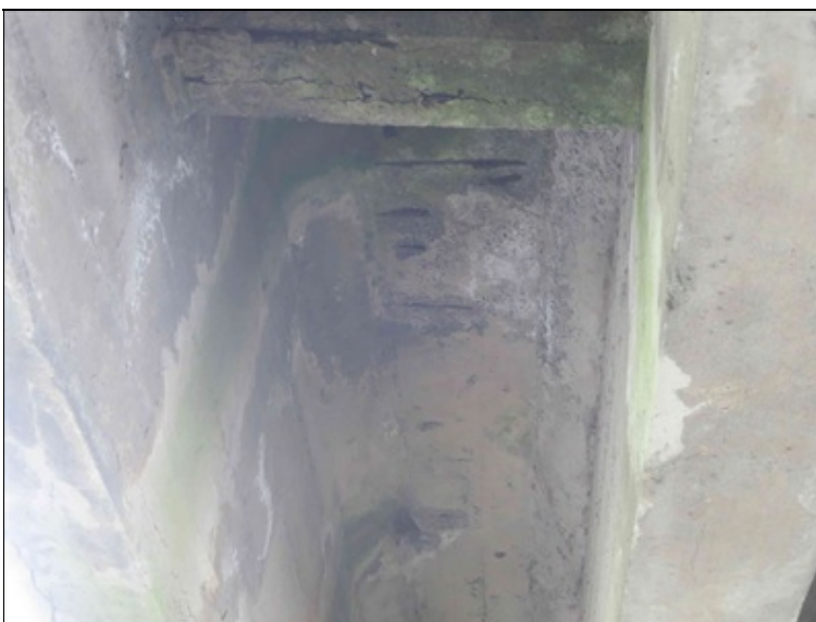
výrazné poruchy desky mostovky a mezilehlého příčnicku mezi 6. a 7. trámem
