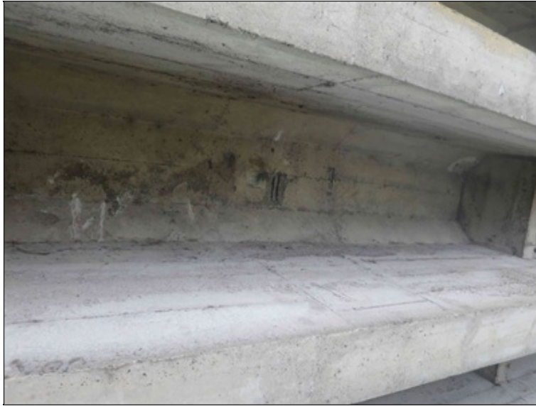
separace krycí vrstvy nad korodující výztuží na spodním líci desky mezi 2. a 3. trámem
