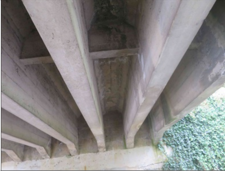
stopy po průsacích deskou mostovky mezi 5. a 6. trámem
