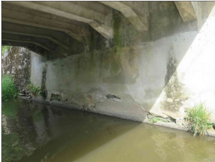
pohled na O1 - v úrovni kolísání hladiny Odavy je patrna lokální hloubková degradace betonu díky opěry
