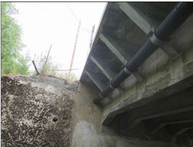
vodovodní potrubí zavěšené pod pravou konzolou
