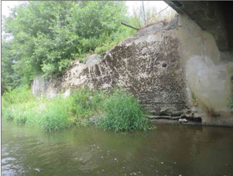
částečně podemletá pravá zeď navazující na O1
