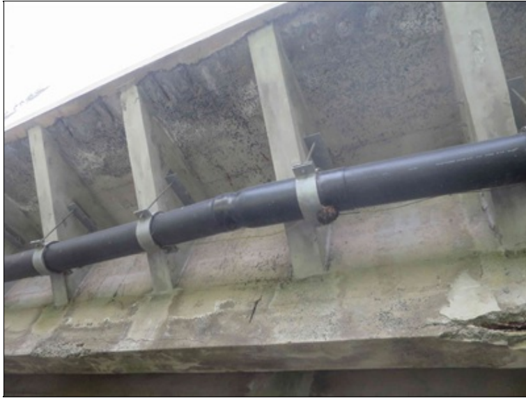
degradace betonu a koroze obnažené výztuže na spodním líci pravé konzoly
