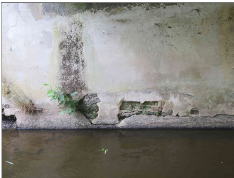
detail hloubkové degradace betonu dřívku O1
