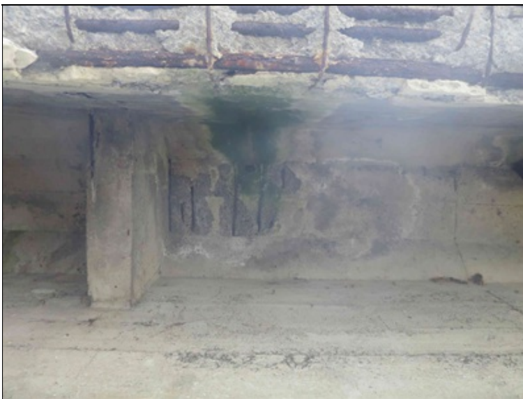
degradace betonu a koroze obnažené výztuže desky v místě průsaku na spodní míči desky mezi 1. a 2. trámem
