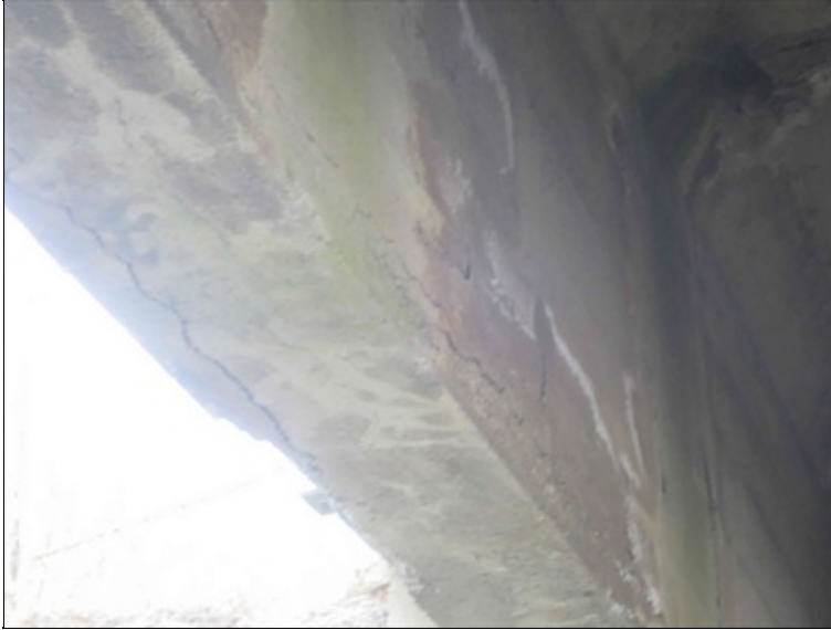
separace krycí vrstvy nad korodující výztuží na spodním líci 7. trámu
