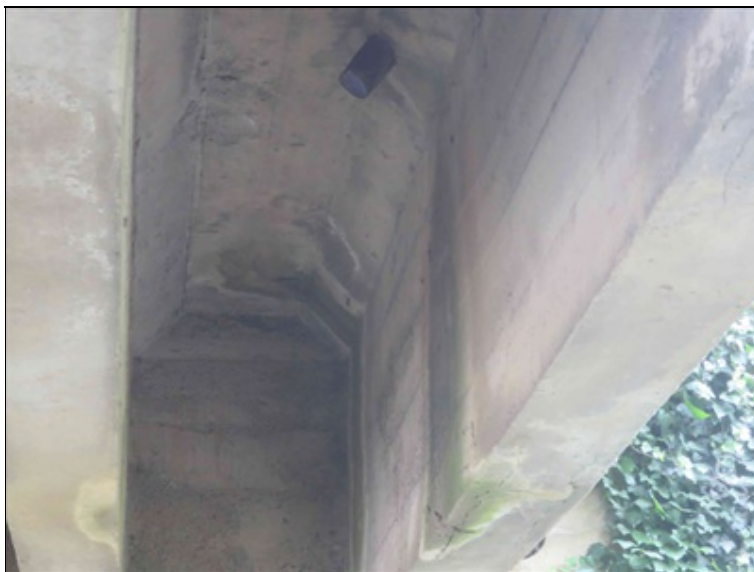
průsaky vně trubky odvodnění na vnitřní bok 7. trámu
