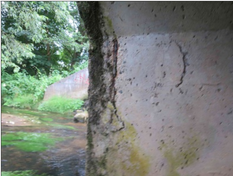
korozí obnažené výztuže na stěně rámu
