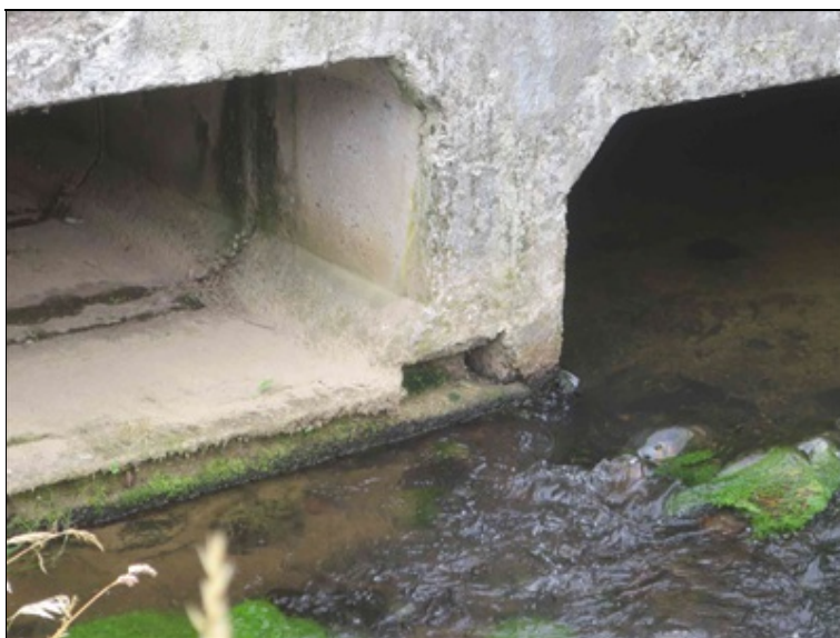
kaverna na levém boku krajního rámu ve 2. poli s degradovaným betonem
