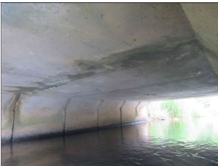
výrazné průsaky sparami mezi prefabrikáty v 1. poli
