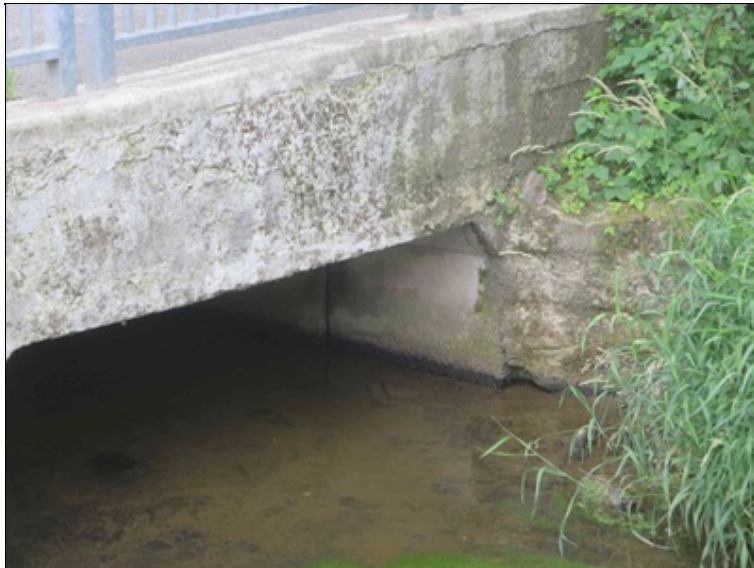
degradace betonu římsy
