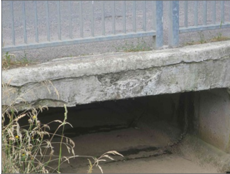
separace krycí vrstvy na vnějším boku levé římsy nad korodující výztuží
