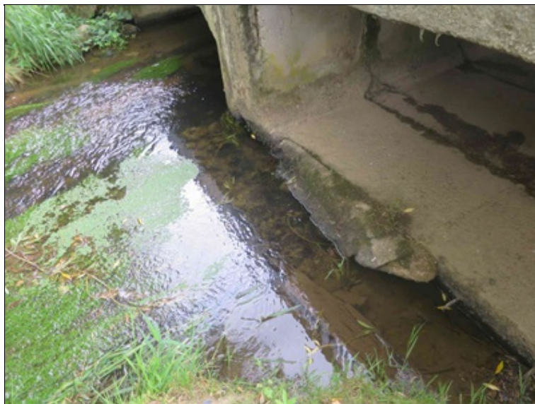
na pravé straně jsou prefabrikáty částečně podemleté
