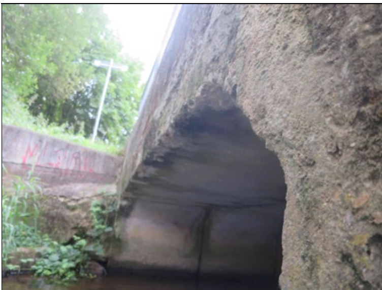
degradace betonu na pravém boku krajního prefabrikátu v 1. poli
