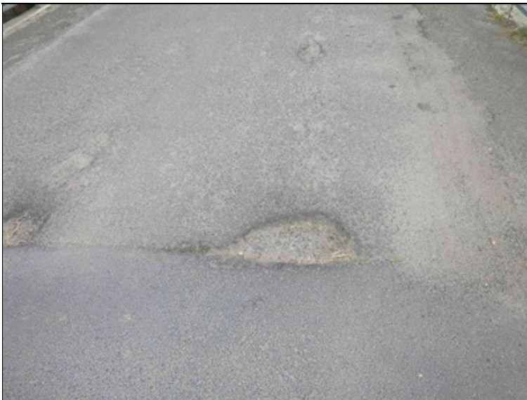
výtluky v krytu vozovky
