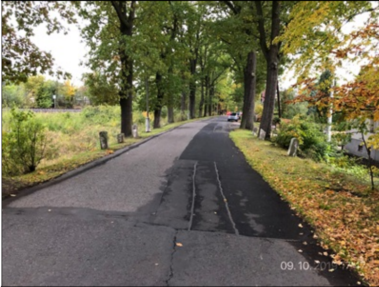
1-šířkové uspořádání absence záchytného zařízení.jpg
