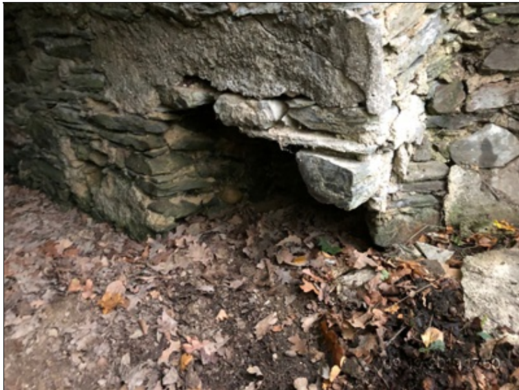
5-kaverna ve zdivu dřívku opěry.jpg
