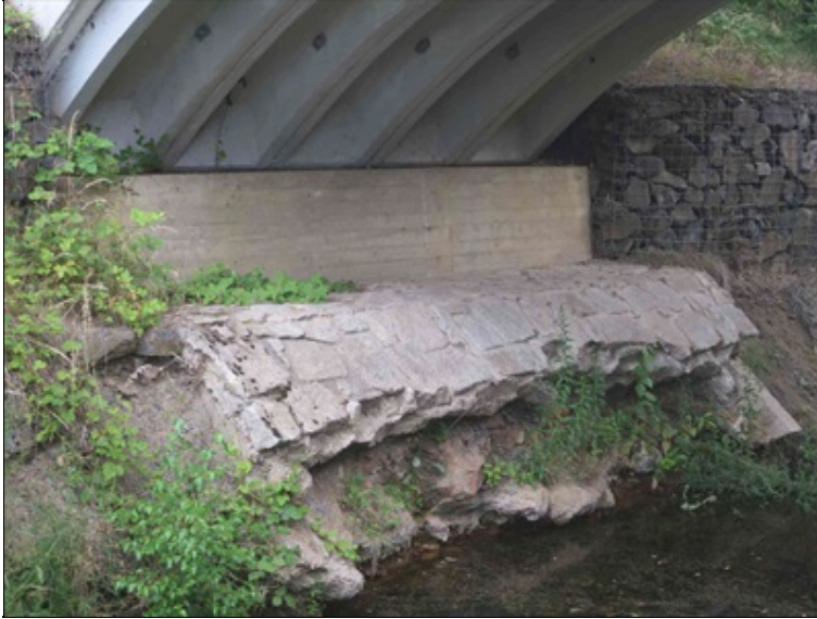
podemleté zpevnění svahu pod opěrou 1
