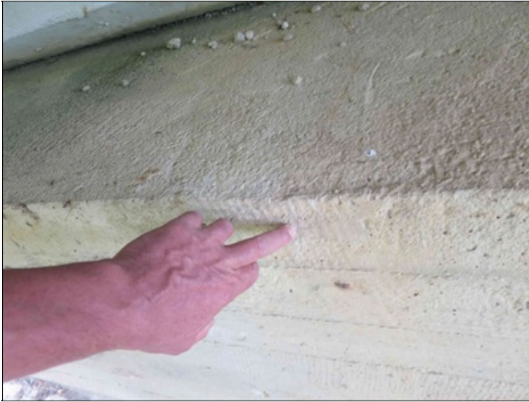
příčná trhlina v dřívku opěry
