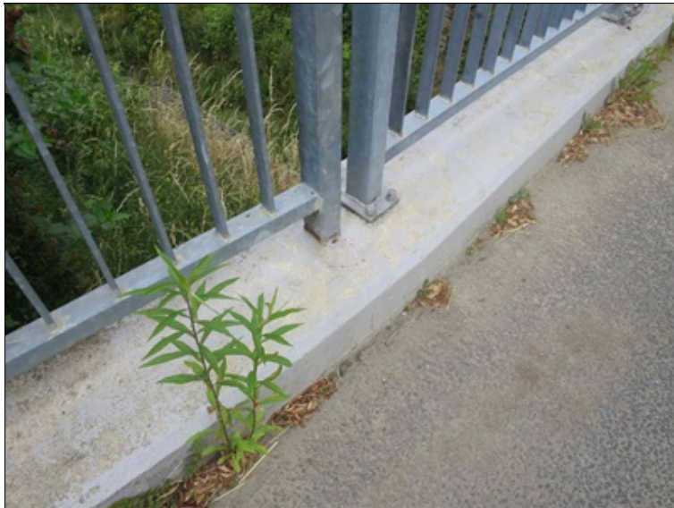
lokální koroze sloupku zábradlí v místě kotvení do římsy
