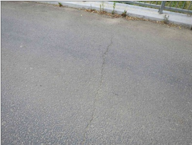
trhlina v krytu vozovky
