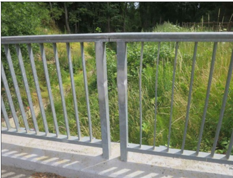
lokální deformace zábradlí
