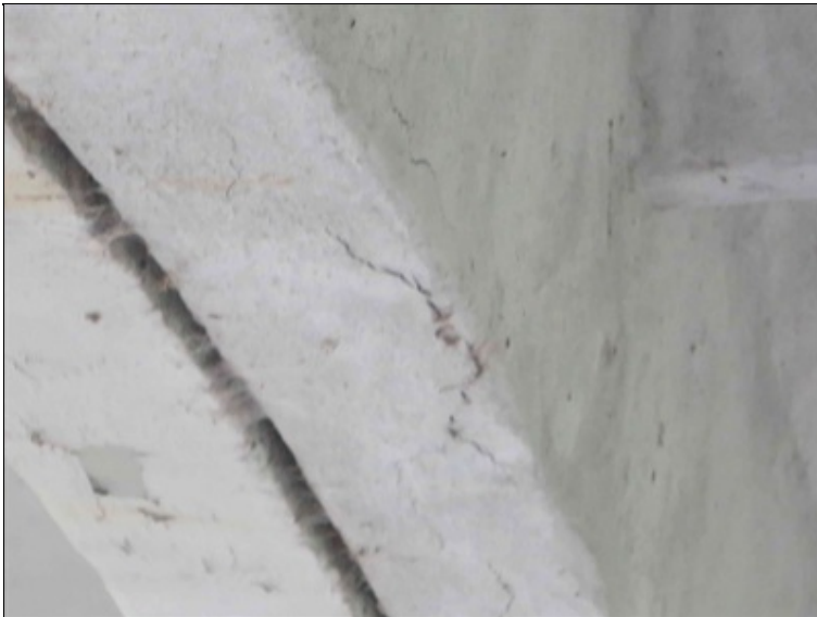
separace krycí vrstvy nad korodující výztuží
