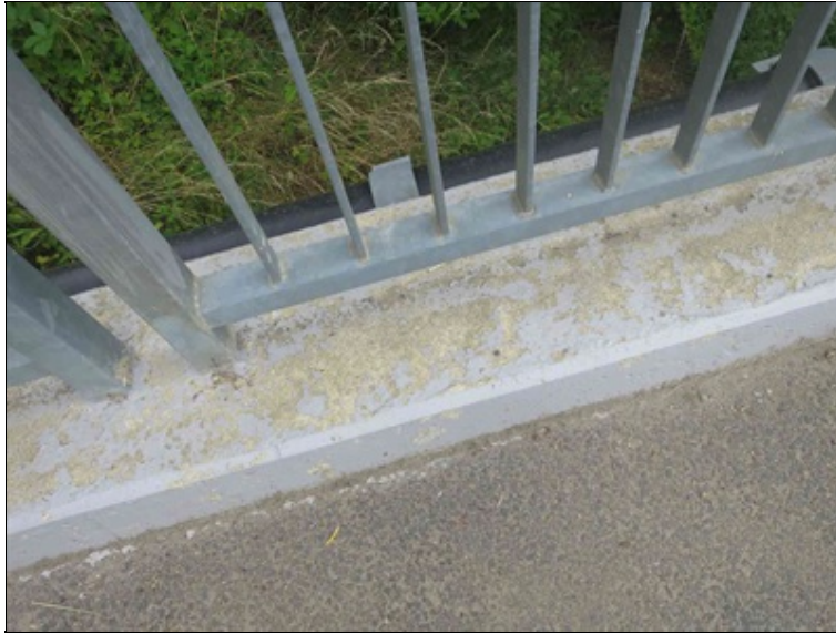
povrchová degradace betonu římsy
