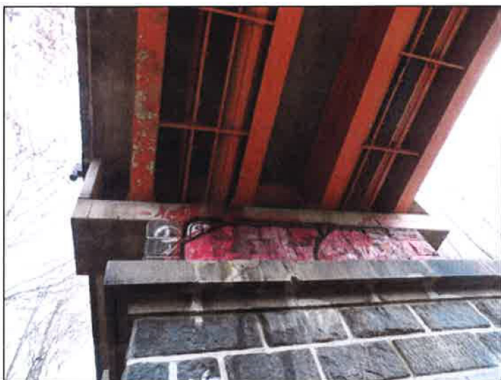
Poruchy PKO. Z nosné konstrukce visí závěs umožňující přístup nepovolaných osob na konstrukci.
