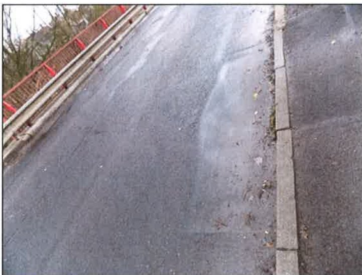
Šikmé trhliny ve vozovce na předmostí O2.
