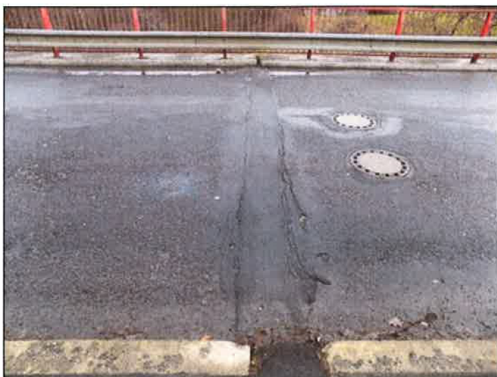
Poruchy MZ nad O1.
