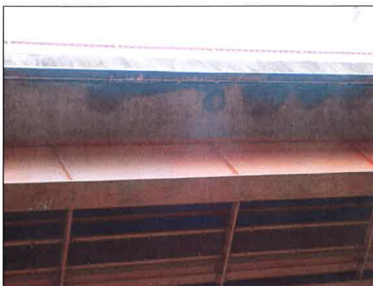
Průsaky zpod římsy na žb. desku NK.
