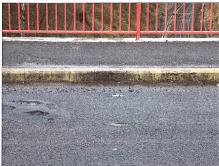
Degradace betonových obrubníků.
