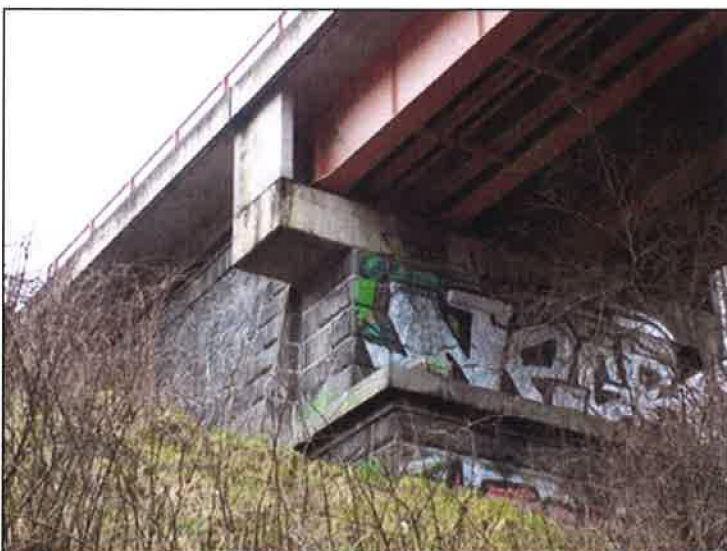
Pohled na O1, zatékání na plentovací zídku a úložný práh.
