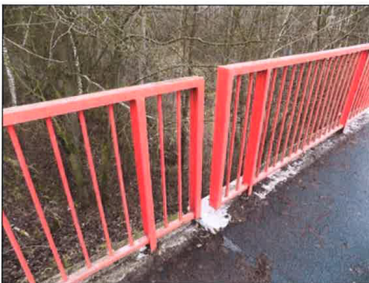
Nenávaznost zábradlí z mostu na předmostí.
