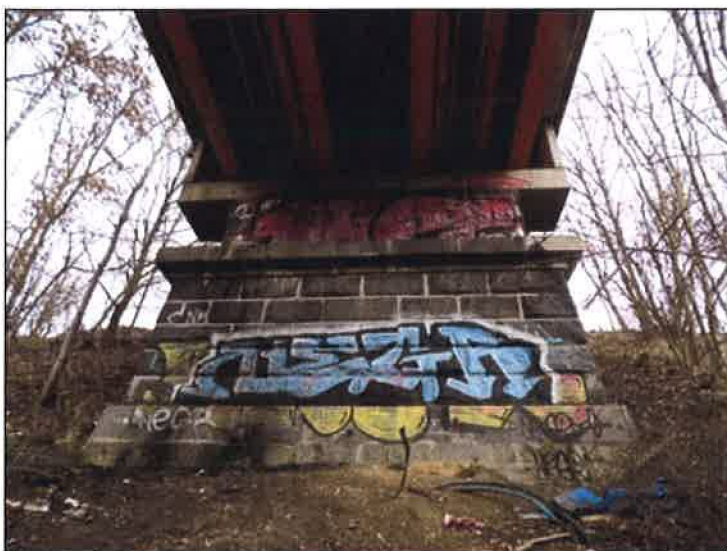
Pohled na O2, zatékání na úložný práh. Z nosné konstrukce visí závěs umožňující přístup nepovolaných osob na konstrukci.
