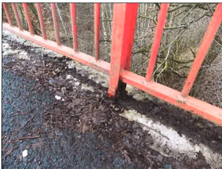
Koroze sloupku zábradlí u jeho zaústění do římsy chodníku.
