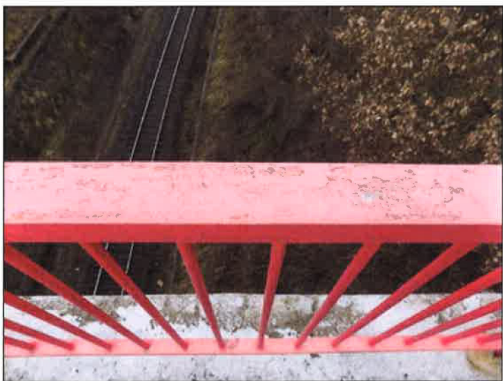
Degradace PKO zábradlí.
