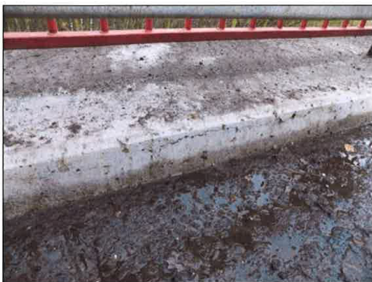
Trhliny v pravé římse.
