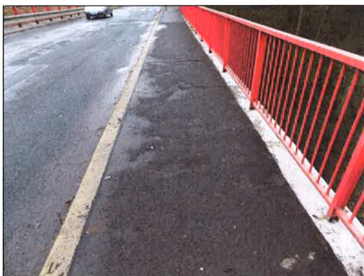
Poruchy krytu chodníku.
