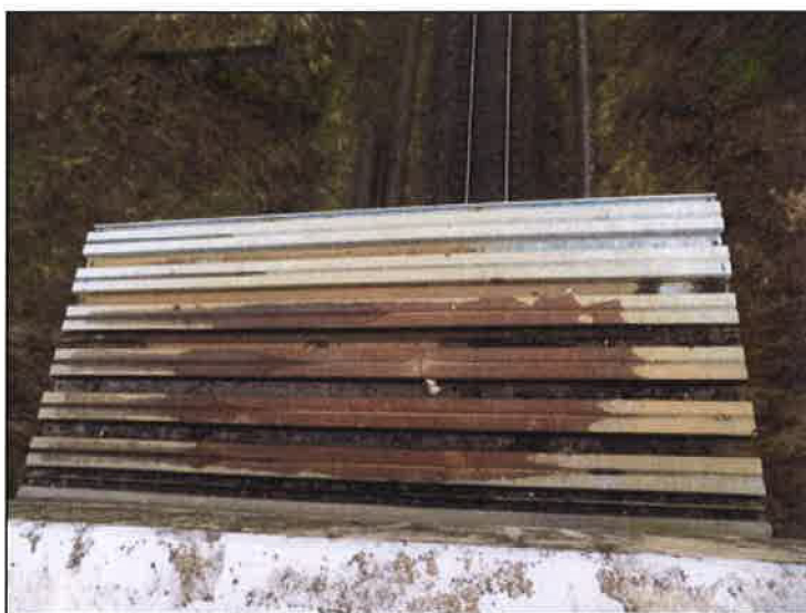
Koroze štítu protidotykové zábrany.
