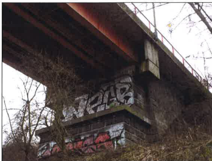
Pohled na O1, zatékání na plentovací zídku a úložný práh.
