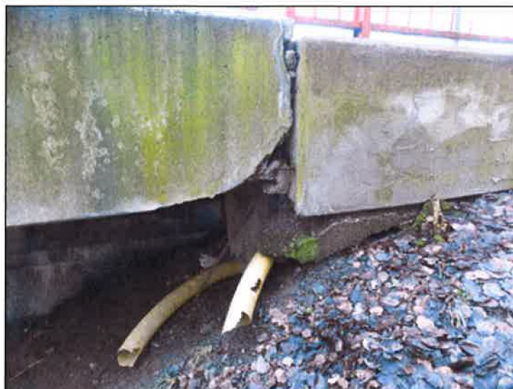
Poškozený římsa chodníku.
