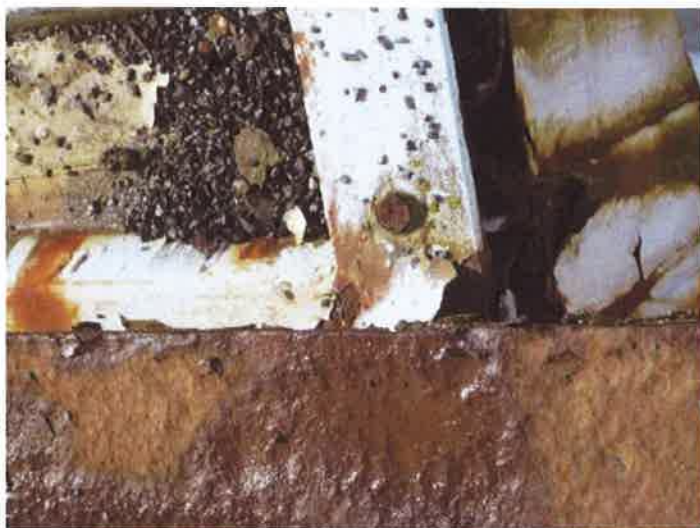
2. východní část NK - výrazná koroze horního plechu komorového průřezu v místě vetknutí konzoly protidotykového štítu
