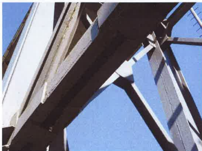
2. východní část NK - výrazná koroze prvků ztužení východního schodiště
