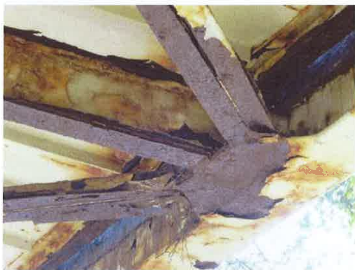
1. západní část NK - výrazná koroze prvků ztužení s úplným prorezavěním v místě napojení na styčnickový plech
