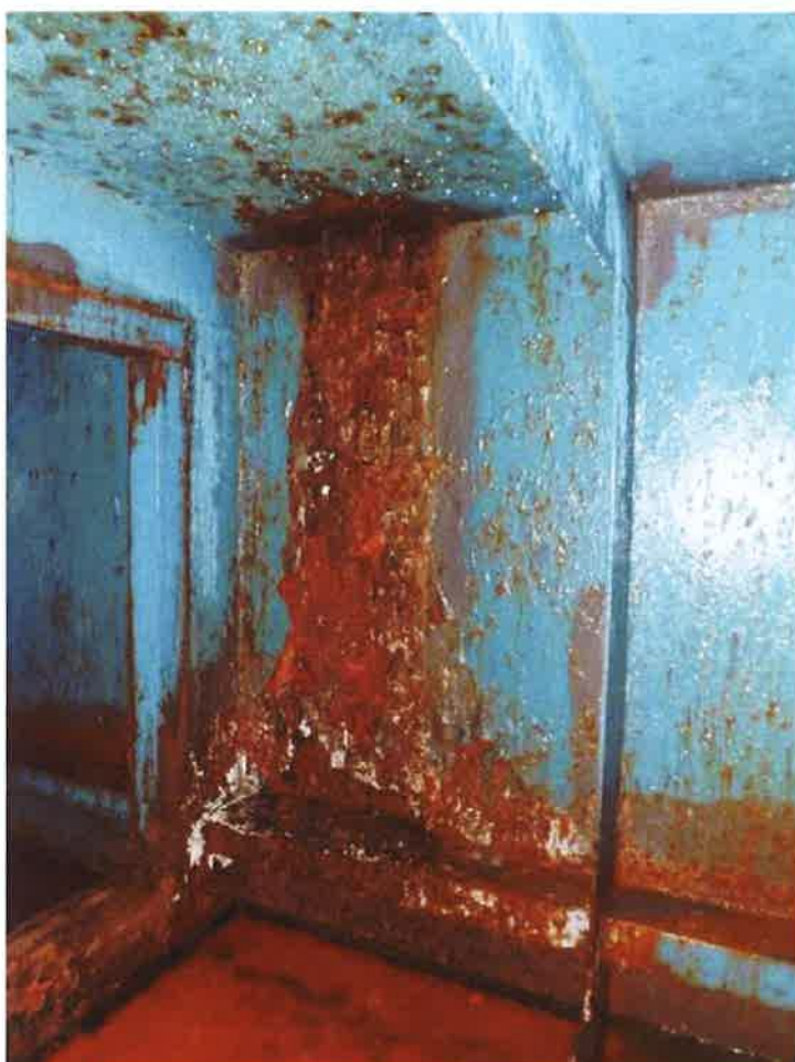
2. východní část NK - výrazná koroze stěny komorového průřezu v místě průsaku
