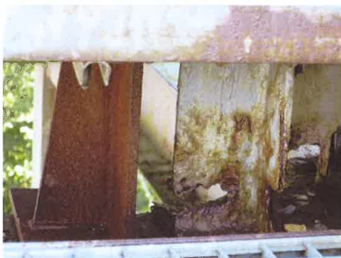
2. východní část NK - správce zajišťuje provizorní opravy schodiště v místě poruch
