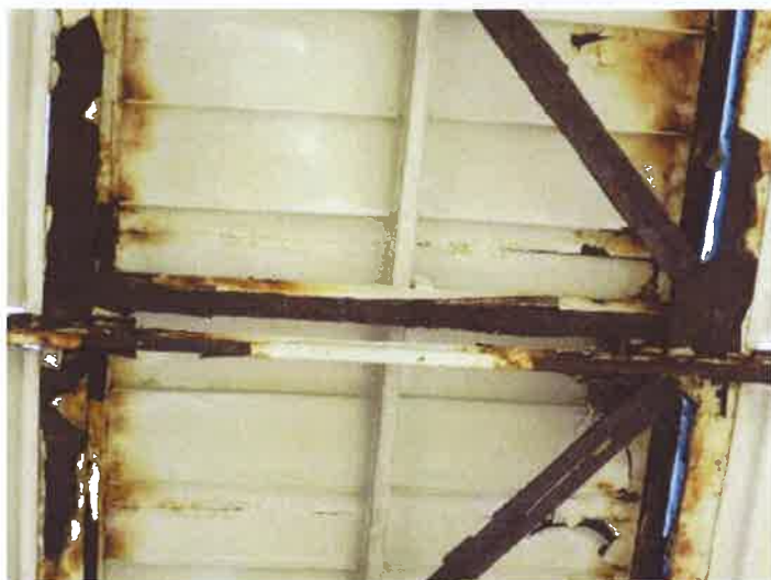
1. západní část NK - výrazná koroze spodních pásnic hlavních nosníků
