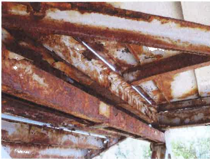
1. západní část NK - výrazná koroze prvků mostovky nad kyvnou stojku P1
