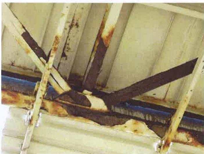
1. západní část NK - výrazná koroze spodních pásnic hlavních nosníků v místě styčnickových plechů
