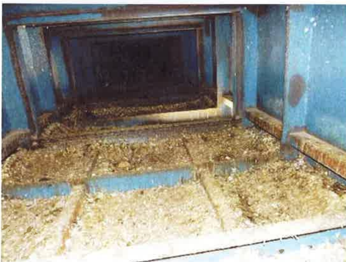
2. východní část NK - zanesený spodní plech komorového průřezu ptačím trusem
