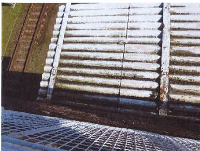
částečně zanesené protidotykové štíty
