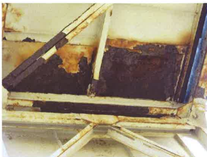
1. západní část NK - výrazná koroze plechu mostovky v oblasti dilatační spáry
