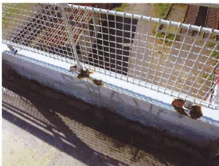
1. západní část NK - výrazná koroze hlavních nosníků v místě osazení zábradlí
