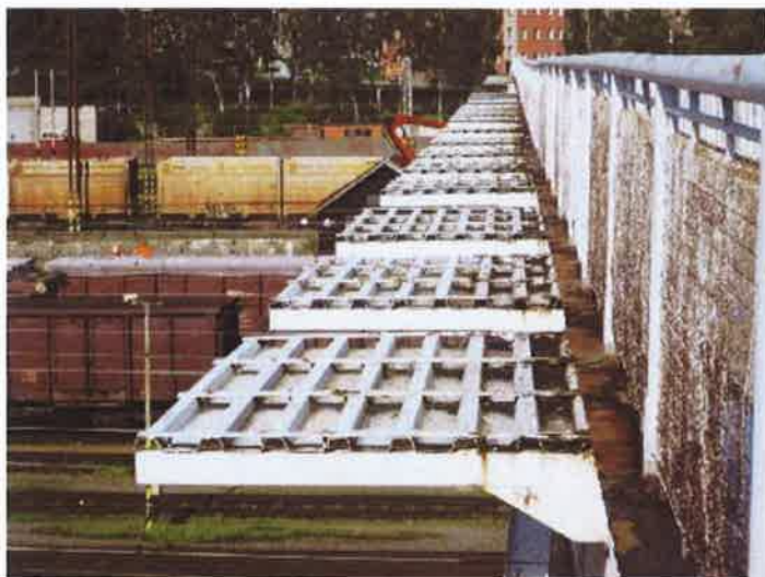
2. východní část NK - výrazná deformace NK je patrna i na linii zábradlí
