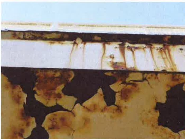
2. východní část NK - výrazná koroze spodního plechu komorového průřezu
