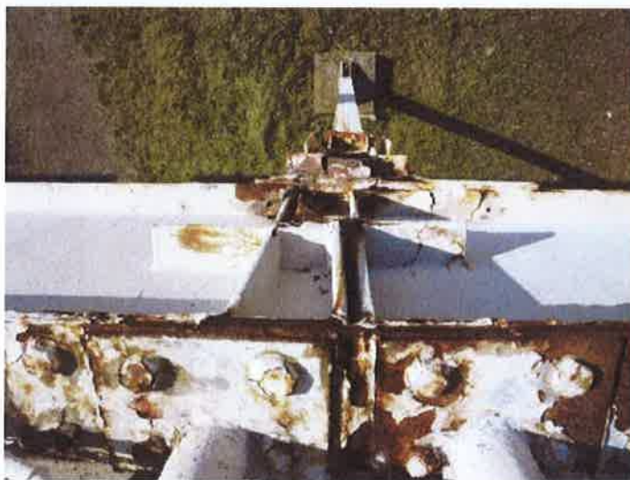
1. západní část NK - výrazná koroze hlavních nosníků v místě osazení na kyvnou stojku s kloubem - P4
