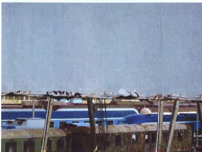
2. východní část NK - výrazná koroze dolního plechu komorového průřezu
