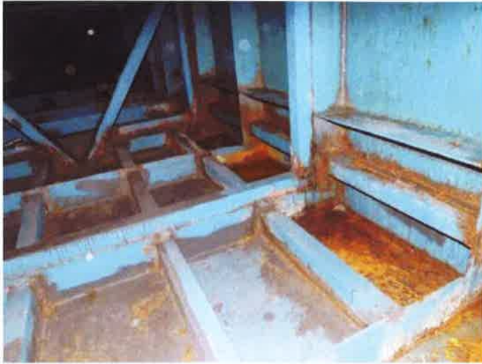
2. východní část NK - výrazná koroze dolního plechu a stěn komorového průřezu
