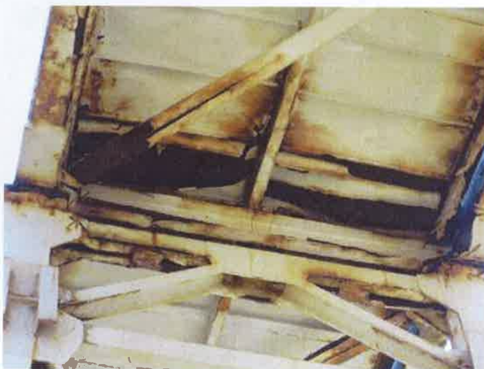
1. západní část NK - výrazná koroze plechu mostovky v místě osazení NK na kývnou stojku
