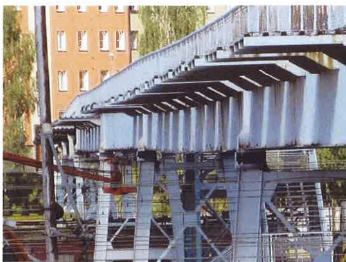
2. východní část NK - výrazná deformace NK
