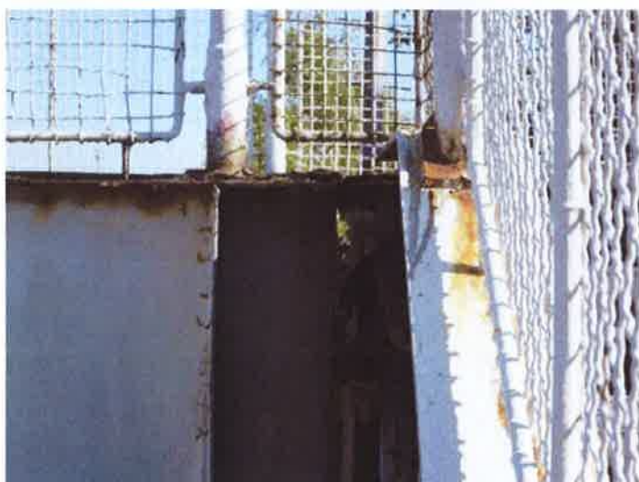
2. východní část NK - výrazná koroze dotčených prvků v místě prosakující dilatační spáry mezi lávkou a východním schodištěm
