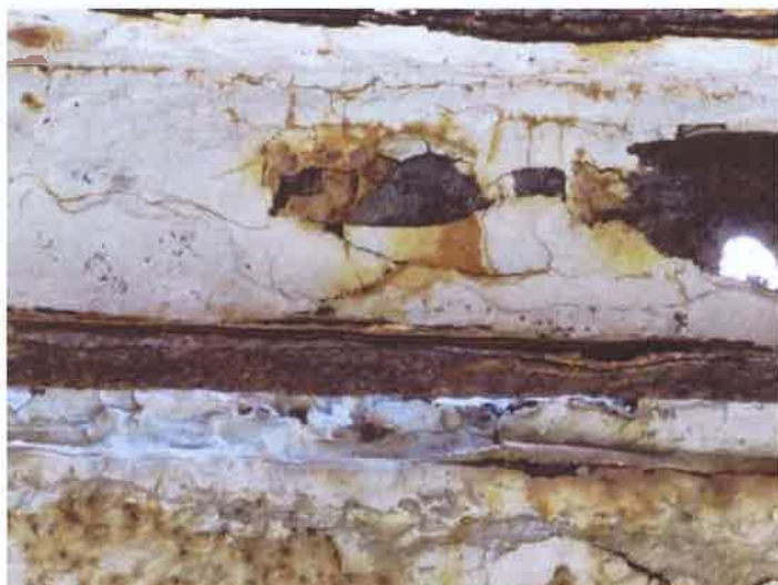
1. západní část NK - výrazná koroze příčnicku s úplným prorezavěním stojiny
