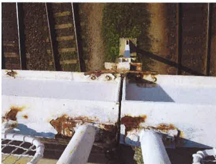
1. západní část NK - výrazná koroze hlavních nosníků v místě osazení na kypnou stojku
