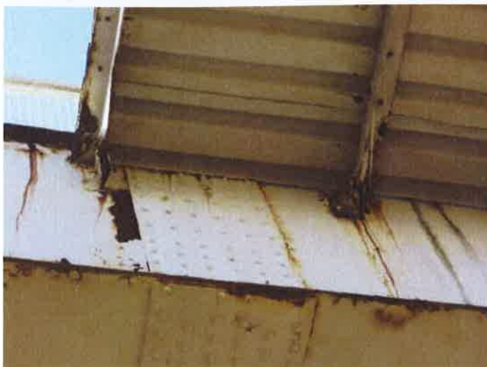
2. východní část NK - výrazná koroze konzol protidotykových štítů v oblasti kotvení
