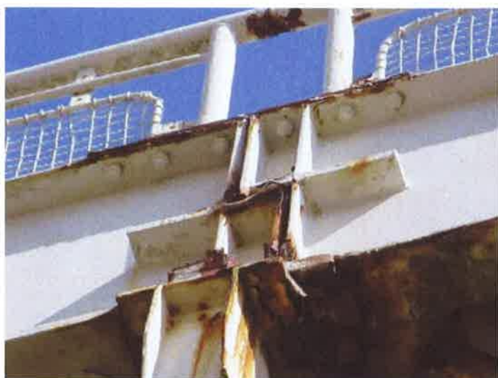
1. západní část NK - výrazná koroze hlavních nosníků v místě osazení na kyvnou stojku s kloubem - P4
