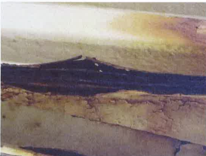
1. západní část NK - výrazná koroze spodní pásnice hlavního nosníku
