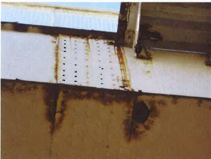
2. východní část NK - výrazná koroze komorového průřezu v oblasti styku
