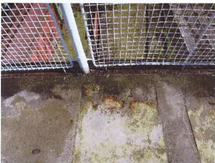
2. východní část NK - výrazná koroze horního plechu komorového průřezu v místě kotvení zábradlí
