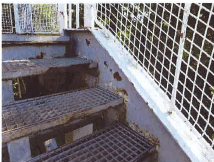
2. východní část NK - výrazná koroze nosníků schodiště v místě kotvení stupnic
