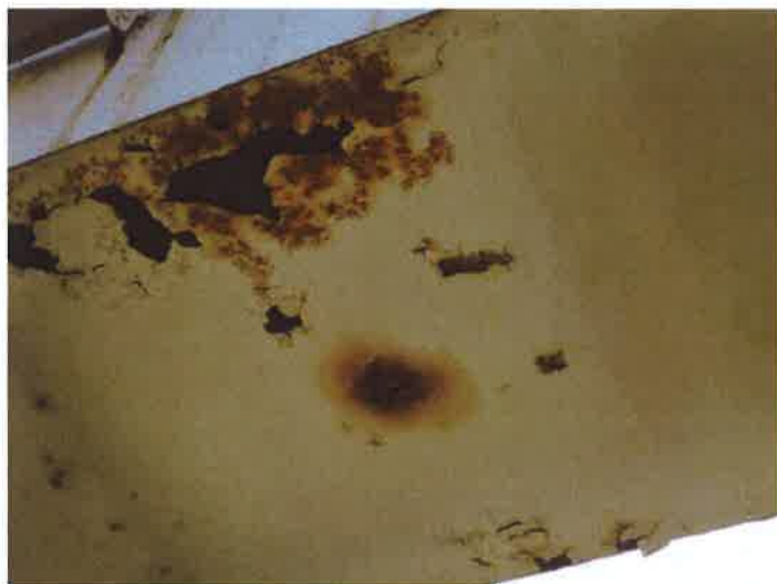
2. východní část NK - výrazná koroze spodního plechu komorového průřezu s úplným bodovým proreznutím
