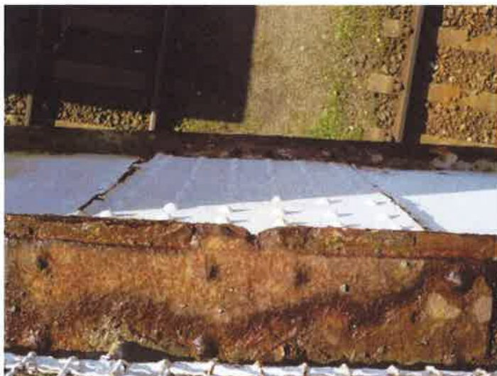
2. východní část NK - výrazná koroze horního plechu komorového průřezu v místě styku
