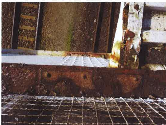
DTTO - tentokrát v místě vetknutí konzoly protidotykového štítu
