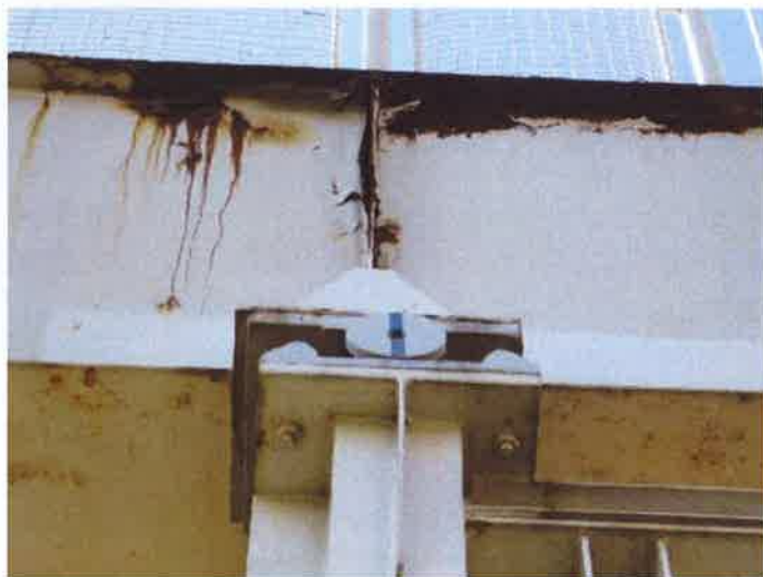
2. východní část NK - výrazná koroze horního plechu a výtuhy komorového průřezu
