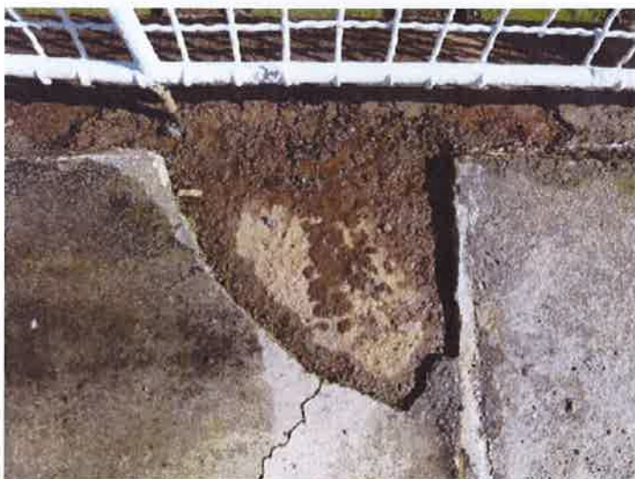
2. východní část NK - výrazná koroze horního plechu komorového průřezu
