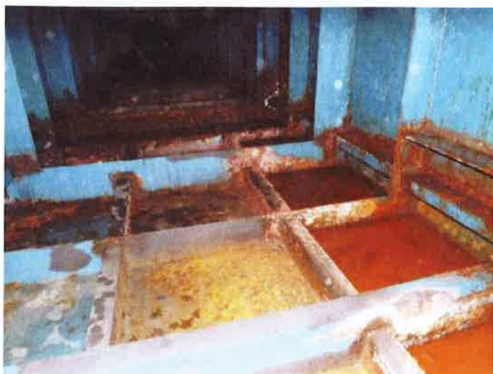
2. východní část NK - výrazná koroze prvků ztužení komorového průřezu
