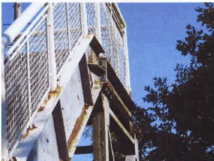
DTTO - koroze v místě napojení nosníků schodiště na podestu
