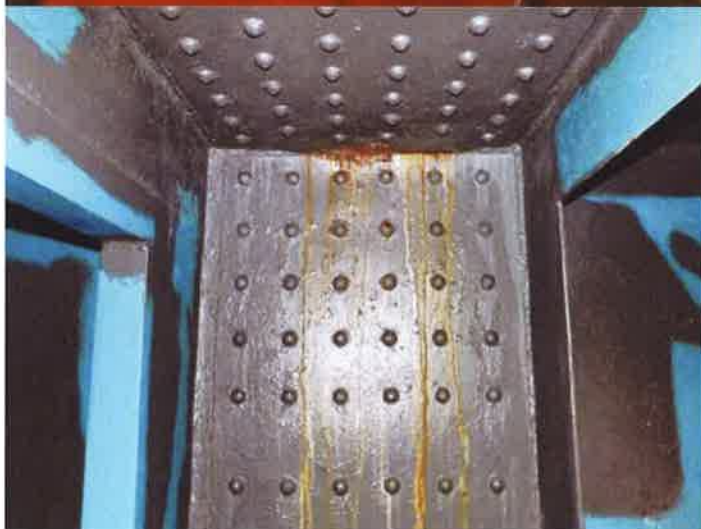
2. východní část NK - koroze v místě styku komorového průřezu
