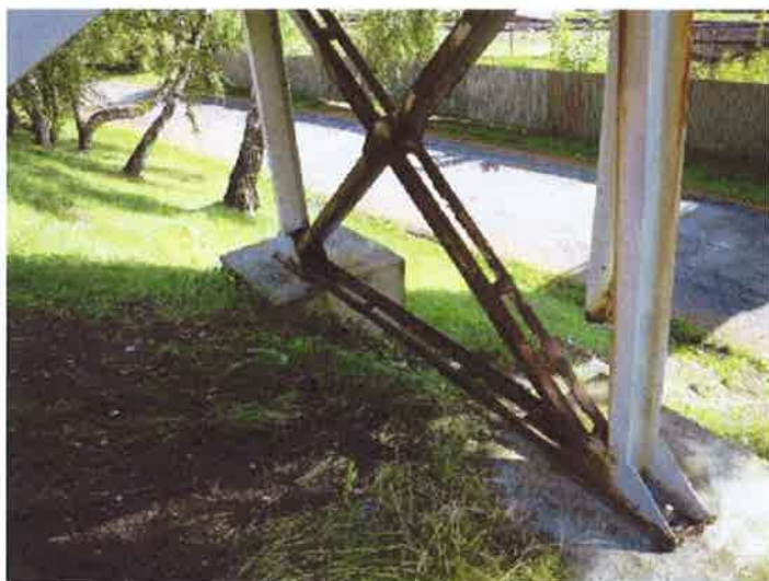
1. západní část NK - výrazná koroze prvků ztužení kyvné stojky P1
