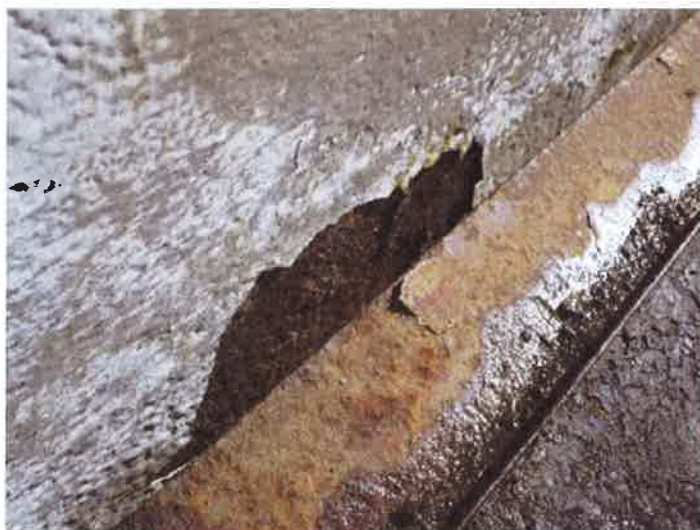
1. západní část NK - výrazná koroze hlavního nosníku v úrovni mostovky
