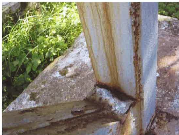
DTTO - koroze stojek schodiště v místě kotvení do základu
