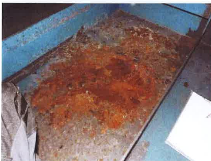
2. východní část NK - výrazná koroze dolního plechu komorového průřezu
